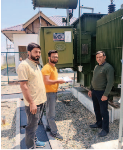
रिसीविंग स्टेशन - बटपोरा शोपियां में ट्रांसफार्मर निरीक्षण/पायलट सर्वेक्षण।
