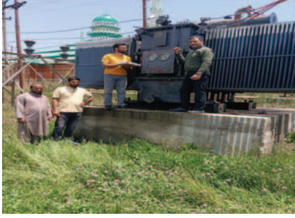
पिंजोरा शोपियां रिसीविंग स्टेशन पर ट्रांसफार्मर निरीक्षण/पायलट सर्वेक्षण।
